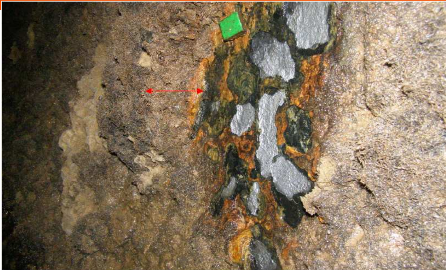
Obr. 11 Boční pohled na povrch s částečně odstraněnými korozními produkty a na k povrchu kolmý „řez“ přes nánosy a korozní produkty (délka řezu vyznačena červenou kótovací čarou)
