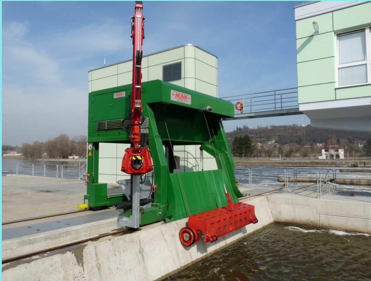
Plně automatický čistící stroj na čištění česel, MVE Trója
